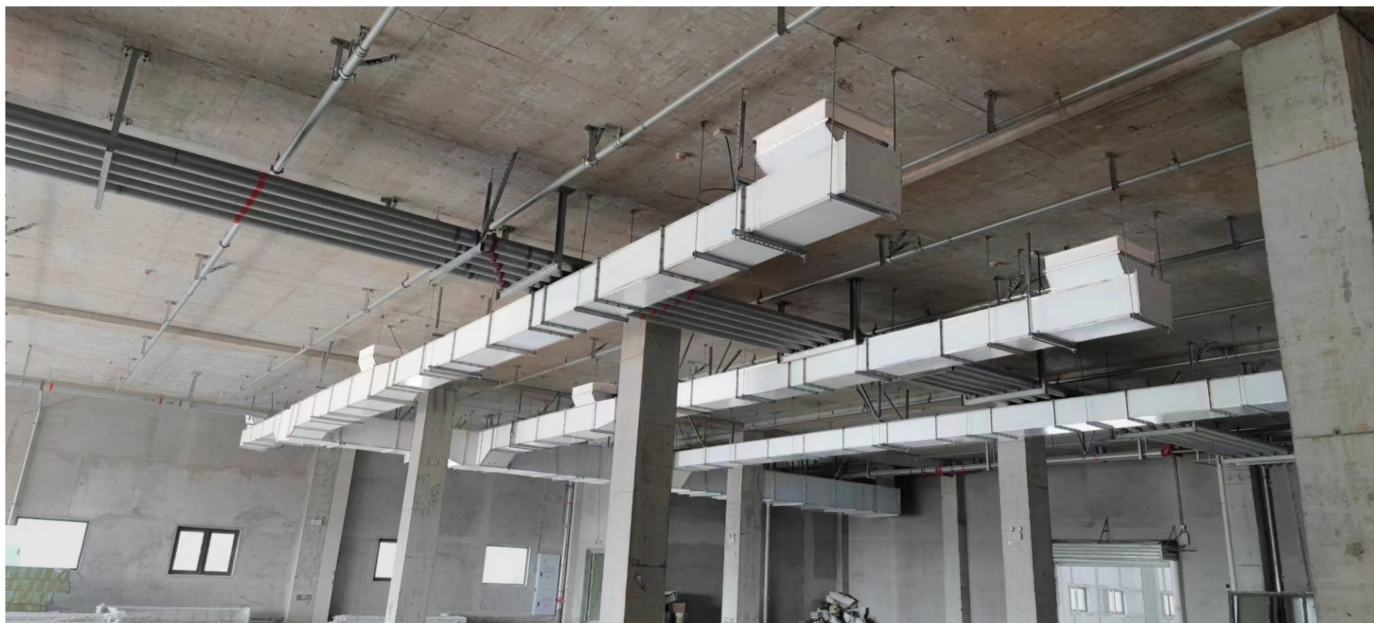
现场实际安装图
